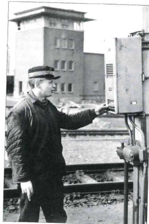
184 Eine bedeutende Verbesserung im Rangierbetrieb der Hafenbahn war die Einrichtung ortsfester Wechselsprechanlagen, wie hier am Stellwerk B 1
